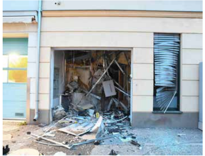
Die Schäden der Explosion bei einem Bankinstitut in Markgrafneusiedl
